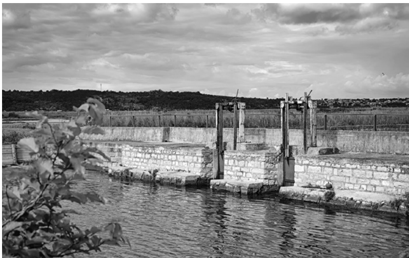
Slika 1: Mehanske zapornice na vhodu kanala Lera (vir: Maja Bjelica, osebni arhiv)
